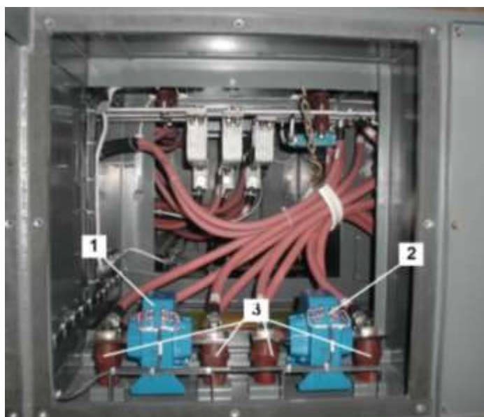
Рис.№8 Расположение оборудования в отсеке
